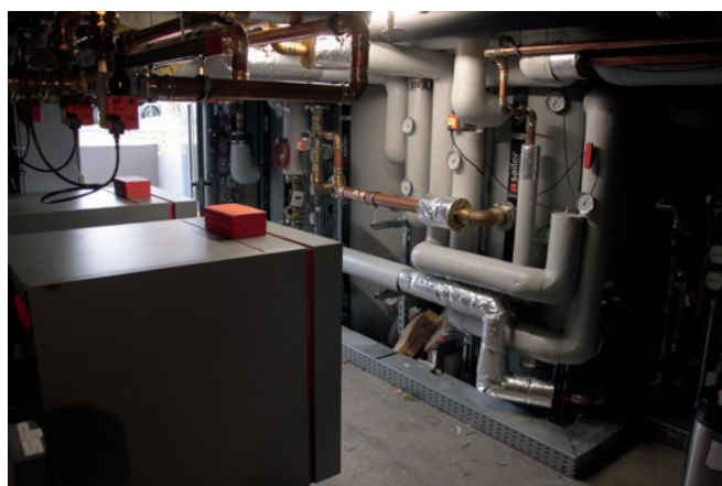
Bild 7 Wärmepumpenkaskade im Heizungsraum
